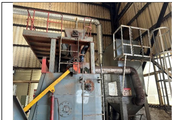
一车间抛丸机 1 及除尘器
