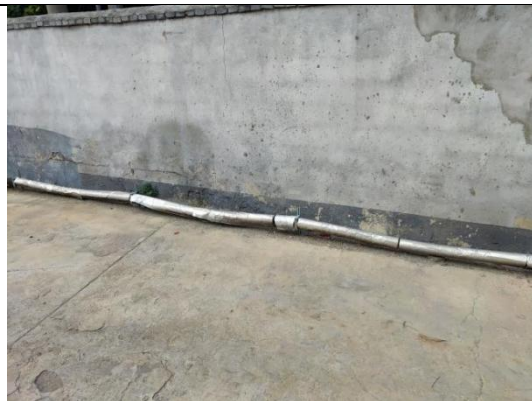
废水架空管线情况
