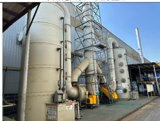
一车间酸雾吸收塔
