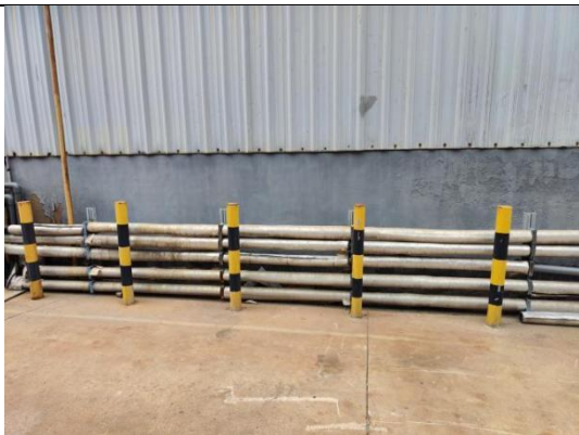
废酸架空管线情况
