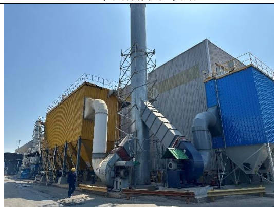
一车间锌烟除尘器
